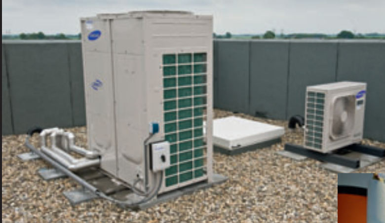
De buitenunit van de DVM-S-warmtepomp van Samsung met rechts daarnaast een extra split-airco om in de koelbehoefte van de serverruimte te voldoen.
