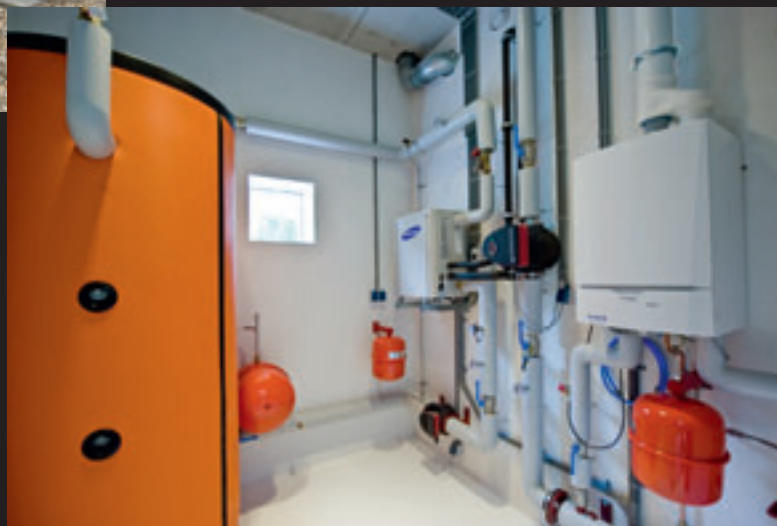
De DVM-S lucht-lucht/waterwarmtepomp levert de energie voor de aan het buffervat gekoppelde hydro-unit die zorgt voor de opwarming van het water voor de vloerverwarming.
