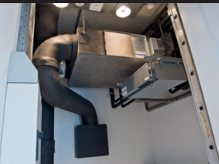
De tww-unit (boven) verzorgt de frisse lucht per verdieping en wordt tevens gebruikt voor nachtkoeling om energie te besparen. De mcu-box (onder) is de verzamelaar van koel- en verwarmingsleidingen naar de kanaalunits in elk vertrek.
